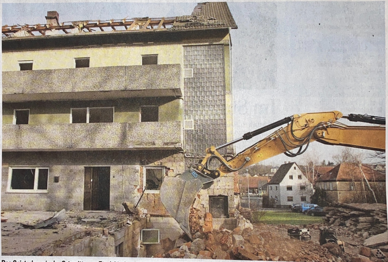
Das Geisterhaus in der Ortsmitte von Etzelskirchen wird abgerissen. Im nächsten Frühjahr soll es mit dem Neubau losgehen.
